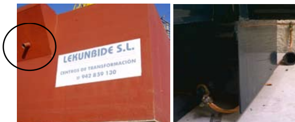
Drenaje de aguas pluviales
