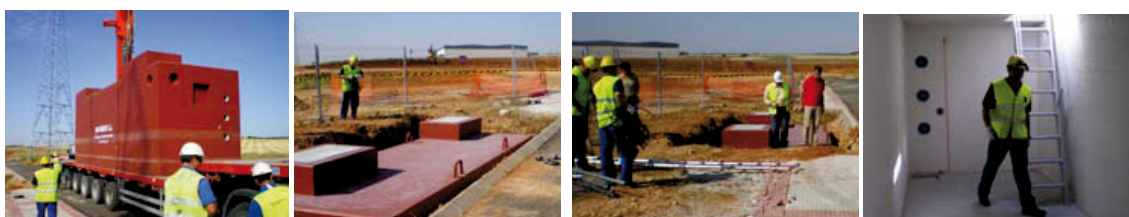
Cámara de Empalme
