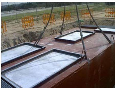
Tapas de transformador y materiales en CT con ventilación horizontal
