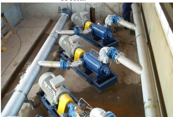
Bombas de impulsión.
