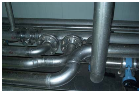
Tubería acero inoxidable.
