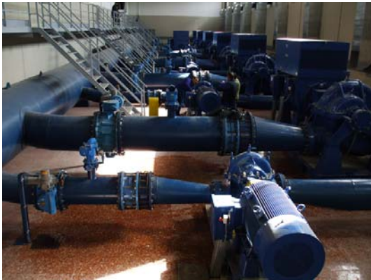
Sistema de impulsión.
