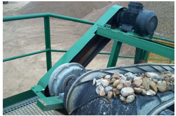
Mantenimiento de Planta de Áridos.
