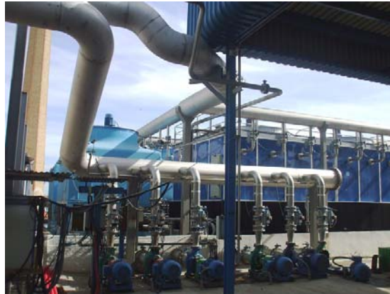
Diseño, construcción y montaje de sistema para impulsión de fluido para industria alimentaría.
