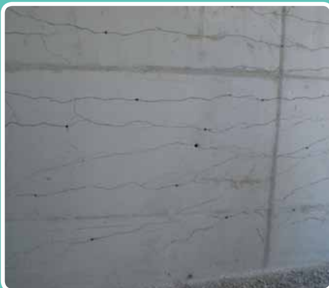
Fisuras de muros por empujes de tierras. Ferrovial Montoro, Córdoba
