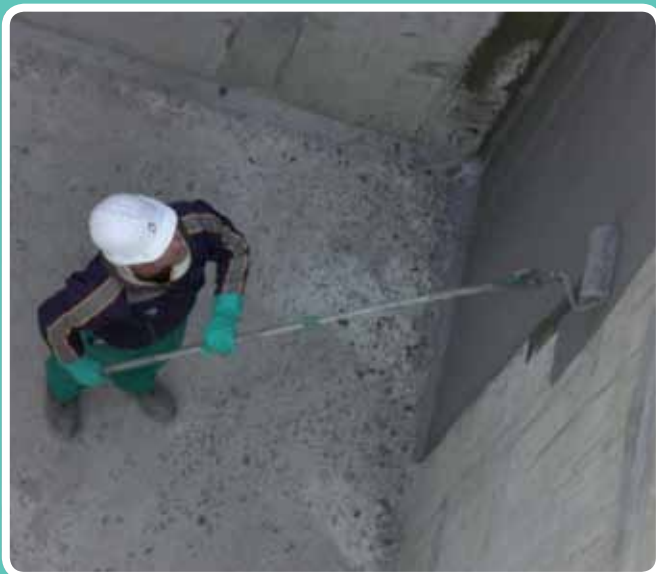
(Revestimiento cementoso) Revestimiento cementoso. Decantadora de Palos de la Frontera
