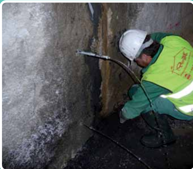
(Juntas muro de pantalla) Canalizando vías de agua. UTE Metro de Sevilla
