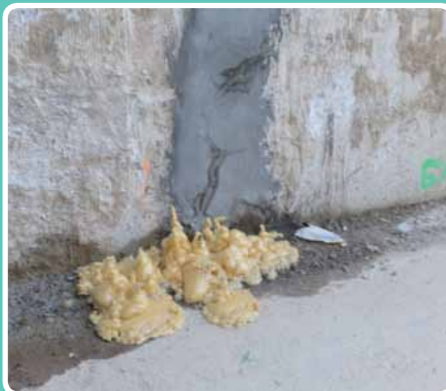
(Juntas muro de pantalla) Junta inyectada y seca. UTE Metro de Málaga
