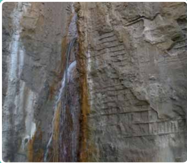
(Juntas muro de pantalla) Abundante agua. Centro Comercial Alcalá Magna. Madrid
