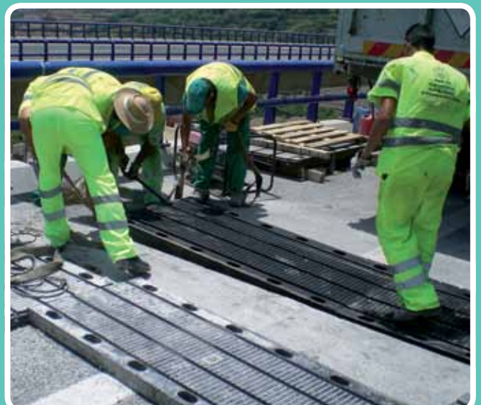
(Colocación de juntas) Colocando el módulo. Ministerio de Fomento, Carreteras del Estado
