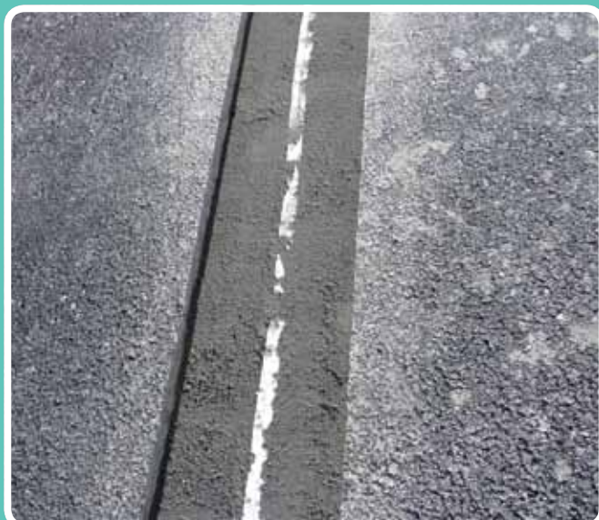
(Aplicación de mortero de nivelación) Mortero nivelado y con junta. UTE SANDO CONACON, Plataforma de Levante
