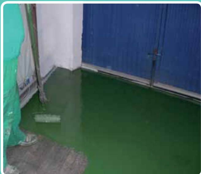
(Pavimentos industriales) Rulo de extracción de aire. Industria del Aguacate, Axerquia, Málaga
