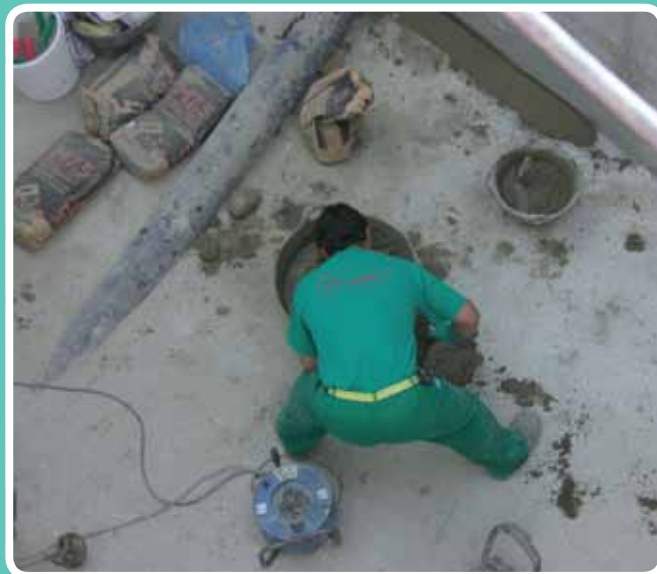
(Revestimiento cementoso) Unión losa Decantadora de Palos de la Frontera
