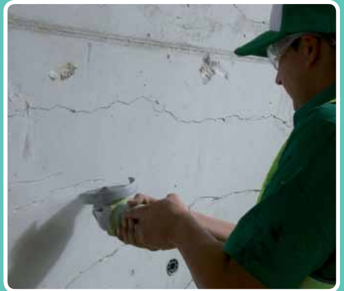
Apertura de fisuras. Ferrovial Montoro, Córdoba
