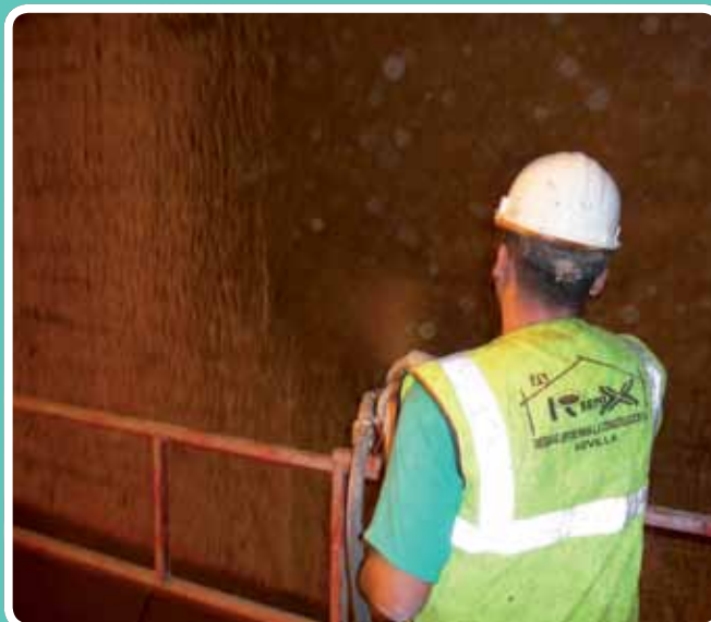
(Maquinaria estática / vía húmeda) Proyección muros pantalla. Nueva plataforma Aeropuerto de Málaga
