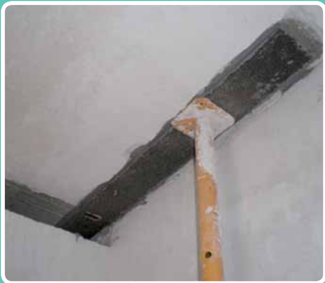
(Refuerzo con elemento metálico) Refuerzo de vigaeta. Intedis del Sur, Sevilla
