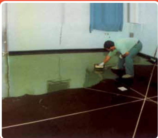
Pavimento antiestático en quirófanos. Hospital Comarcal de Riotinto (Huelva)
