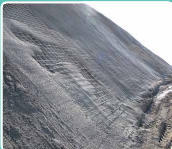
(Maquinaria estática / vía húmeda) Talud. Base Aérea Morón de la Frontera
