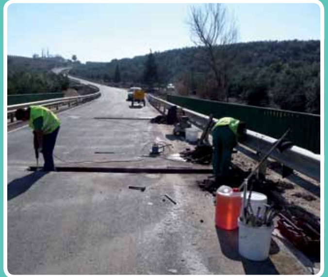
(Replanteo de perforaciones y limpieza) Equipo trabajos media calzada Ayto. de Montoro, Córdoba
