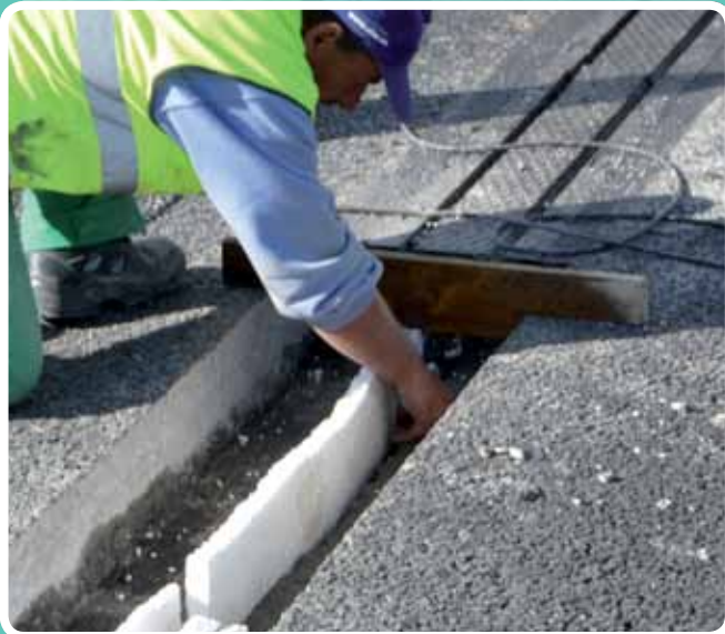
(Aplicación de mortero de nivelación) Nivelando hasta el grueso de la junta. JICARSA, a-334
