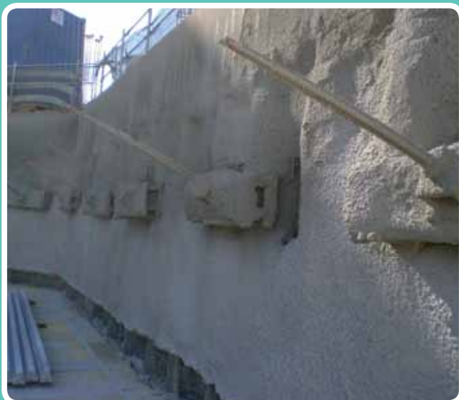
(Maquinaria estática / vía húmeda) Conexión con forjado. Promociones TEZANOS, Madrid
