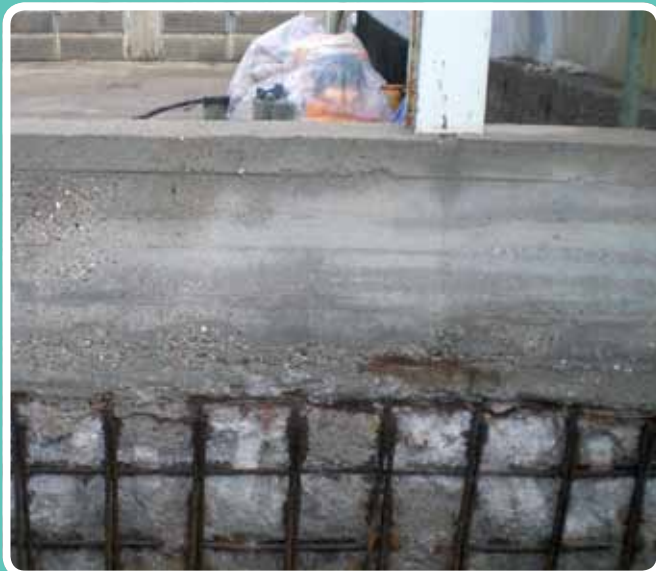
Armadura dañada. Siderúrgica Sevillana S.A.
