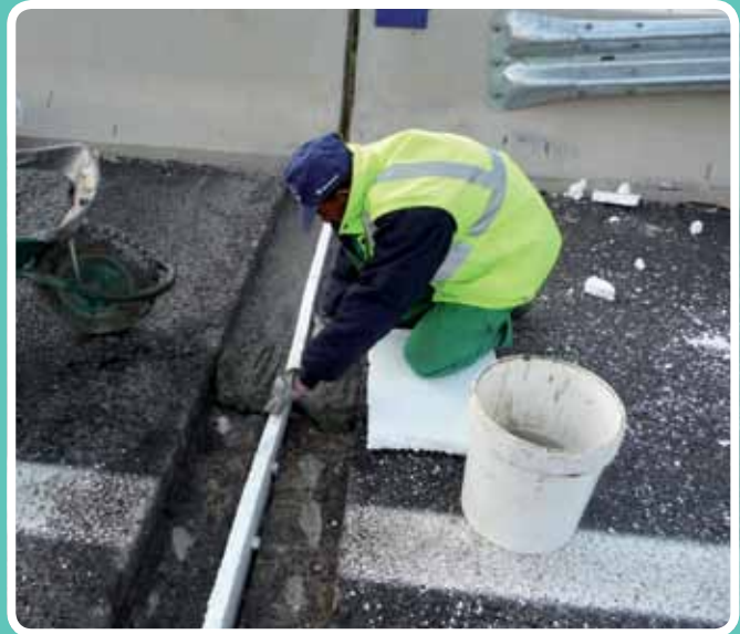
(Aplicación de mortero de nivelación) Colocación de fondo de junta UTE Barbanza, Santiago de Compostela
