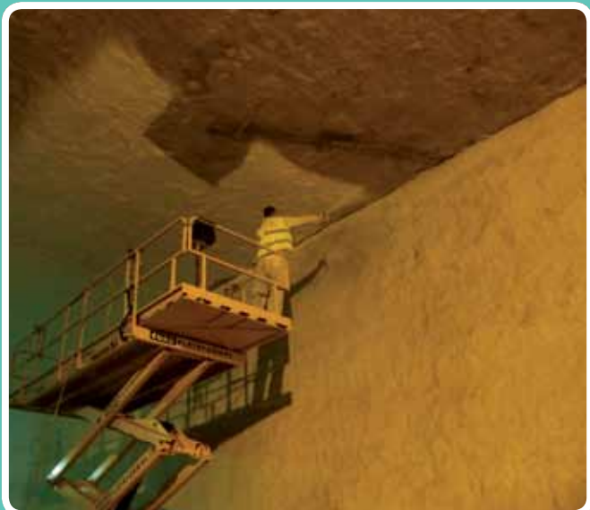
(Revestimiento ignífugo) Aplicación sobre dintel. Integración AVE Málaga, tramo estación del AVE
