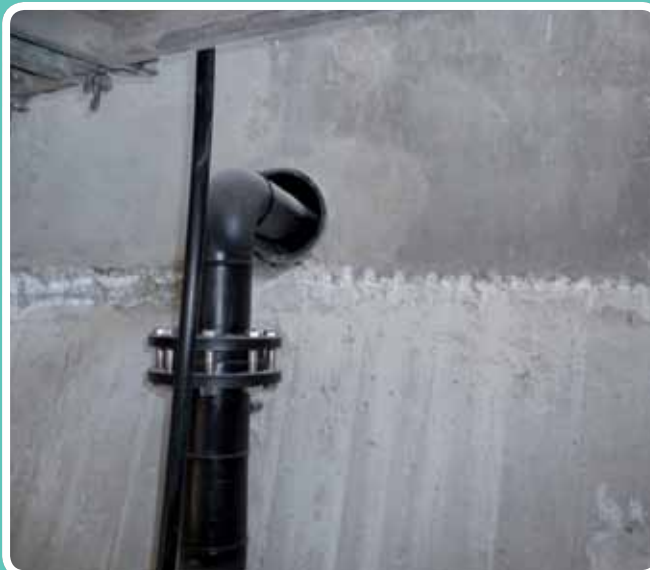
(Depósitos de revestimiento epoxi) Saneo de encuentros. Nueva Central de Ciclo Combinado de Málaga
