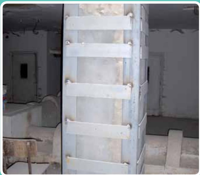
(Refuerzo con elemento metálico) Verticalidad refuerzo a compresión Constructora San José, C/ Don Fadrique, Sevilla
