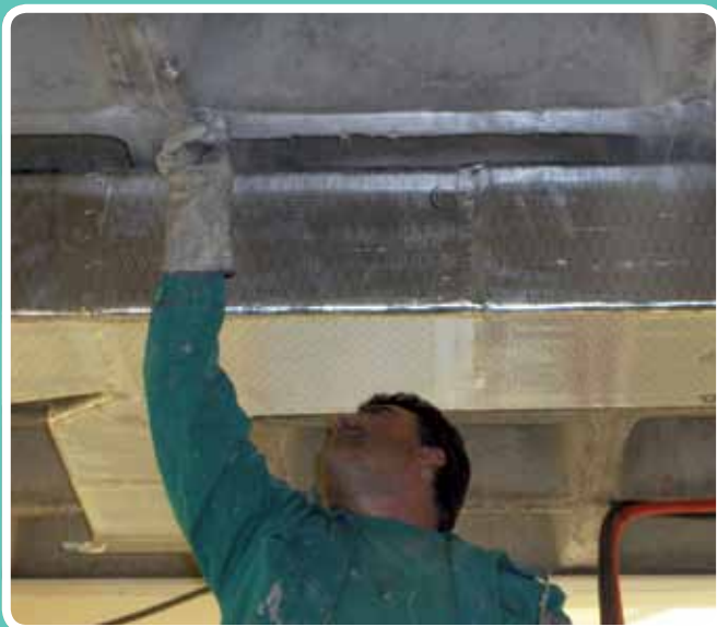
(Refuerzo con fibra de carbono) Imprimando el soporte. Ayuntamiento de Montoro, Córdoba
