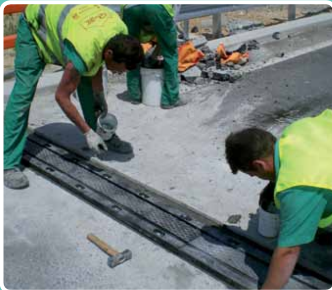
(Relleno banda transición y par de apriete) Fijando los módulos ISOLUX-CORSAN Autovía A40
