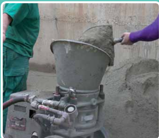
(Maquinaria estática / vía seca) Máquina vía seca. Base Aérea Morón de la Frontera
