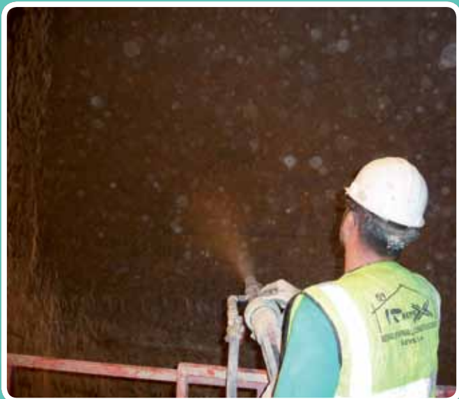
(Maquinaria estática / vía húmeda) Gunita manual. UTE Nueva pista, Aeropuerto de Málaga
