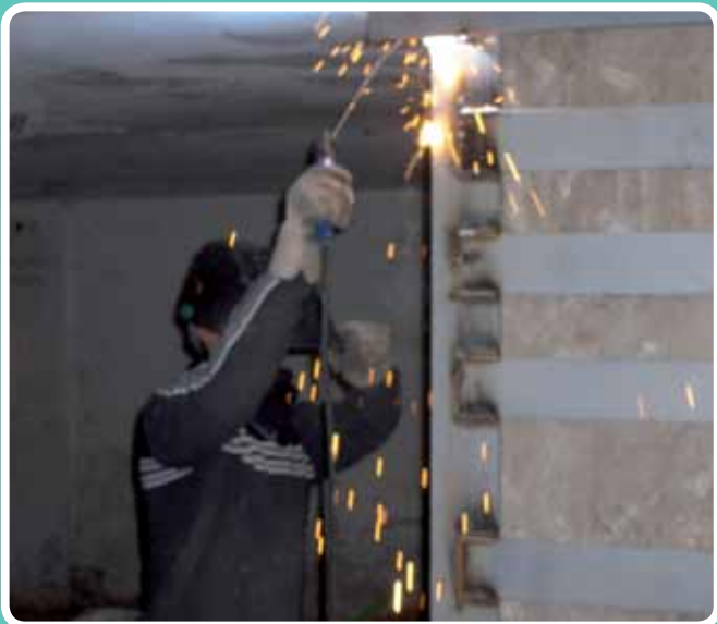
(Refuerzo con elemento metálico) Soldando los angulares. Constructora San José, C/ Don Fadrique, Sevilla
