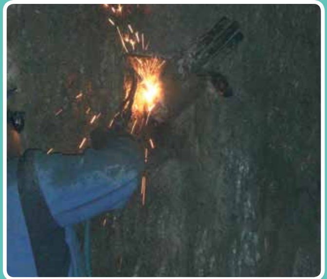
(Sellado de anclajes) Corte de anclaje. Nueva Sede de Urbanismo, Dragados, Málaga
