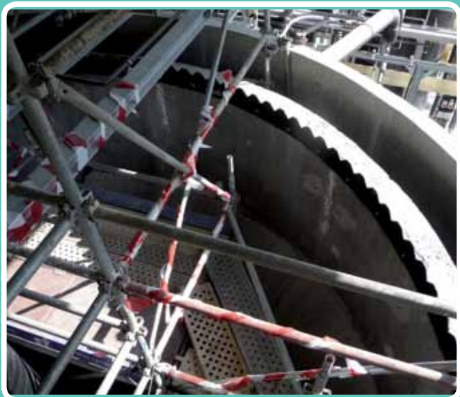
(Depósitos de revestimiento epoxi) Replanteo. Nueva Central de Ciclo Combinado de Málaga
