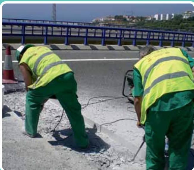
(Corte y cajeo) Cajeo previo al mortero nivelación. SAFYR Acceso al Puerto de Málaga
