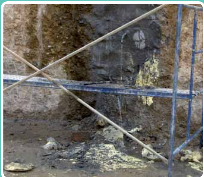
(Juntas muro de pantalla) Junta conflictiva. UTE Metro de Málaga
